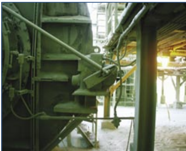
Kiln ID Fan Damper
