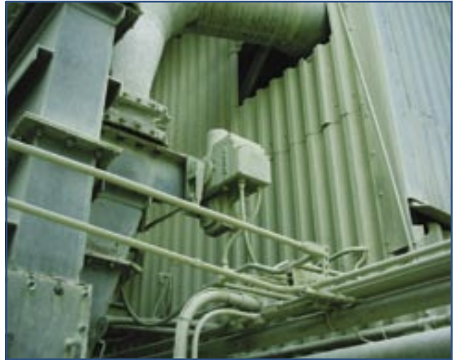
Kiln Reverse Air Fan Damper
