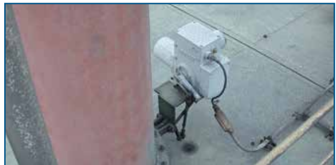
Kiln Reverse Air Fan Damper
