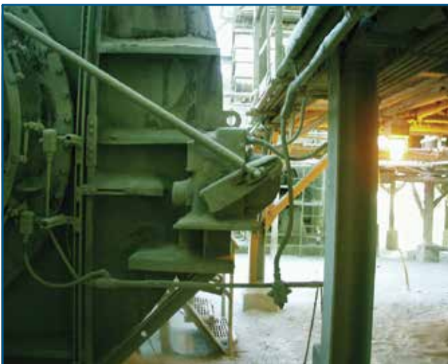
Kiln ID Fan Damper
