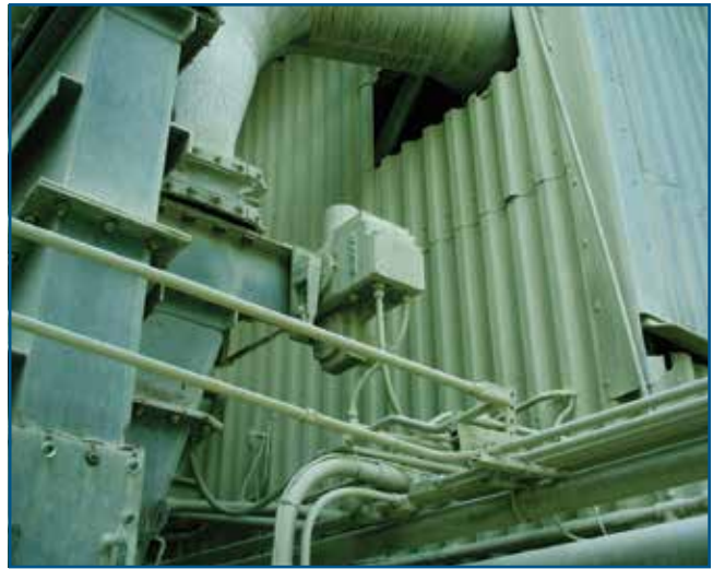
Kiln Reverse Air Fan Damper
